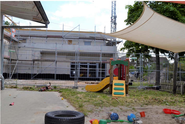
Direkt an die im Jahr 2012 neugebaute Krippe grenzt der Neubau des Kindergartens Rosengarten an.
